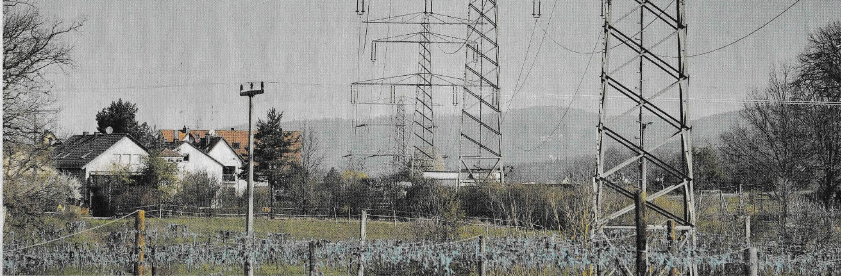
Bei Rollhofen [Gemeinde Neunkirchen] führt die bestehende 110-Kilovolt-Leitung knapp an den Häusern vorbei. Wie viel Abstand hält die P44mod-Trasse ein?
